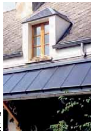
Des capteurs thermiques sont utilisés comme auvent et offrent une protection solaire d'été. Maison rurale à Milon-la-Chapelle (78) © PNRHVC
